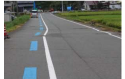
熊本地震で生じた横ずれ断層（益城町）
